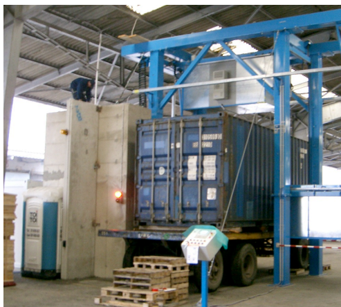
Figure 4 : le portique d'inspection.
